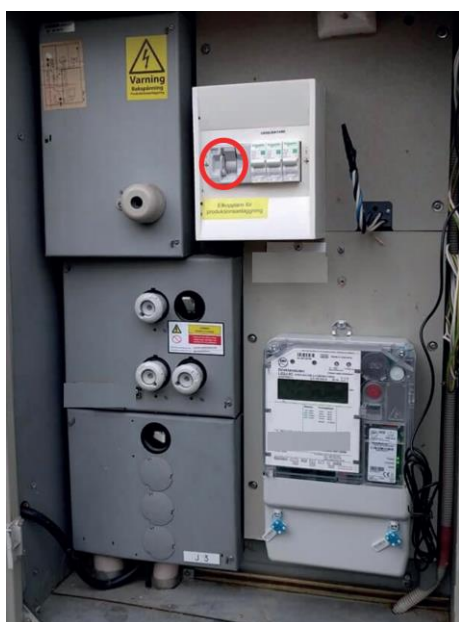
Bild 2 Mätplats med en ny låsbar elkopplare som är rätt placerad efter elmätaren.
