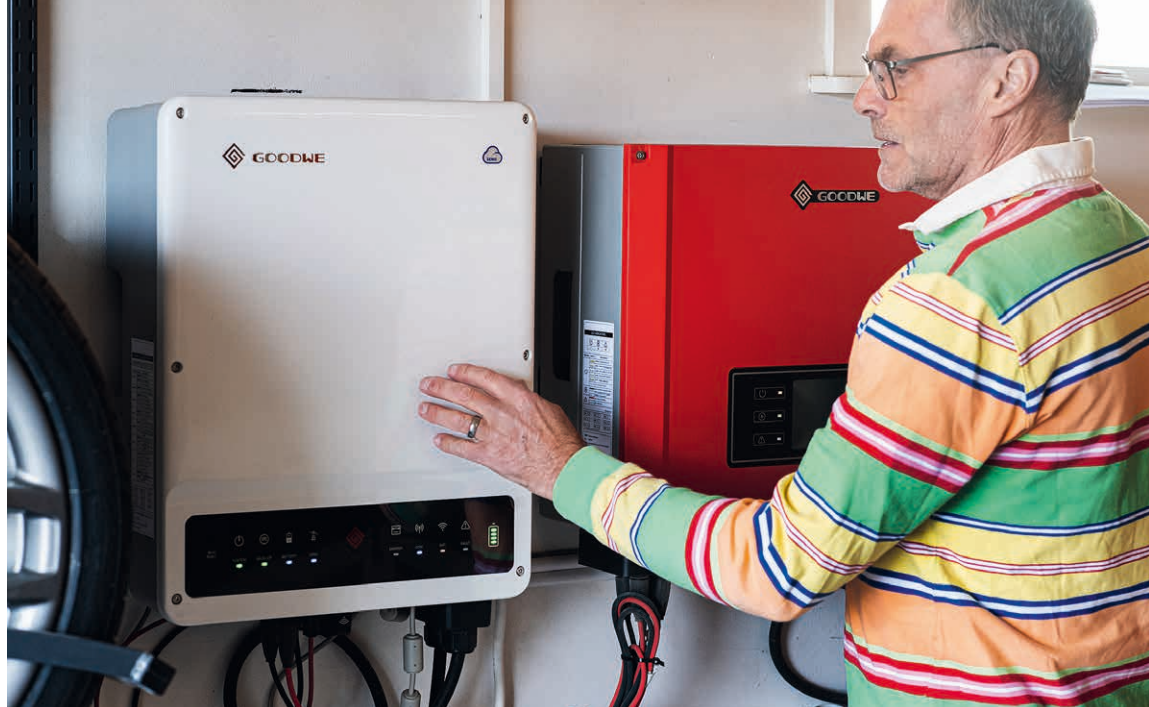
► De båda växelriktarna finns i garaget. Den vita enheten är hybrid-växelriktaren som styr laddningen av batteriet.
